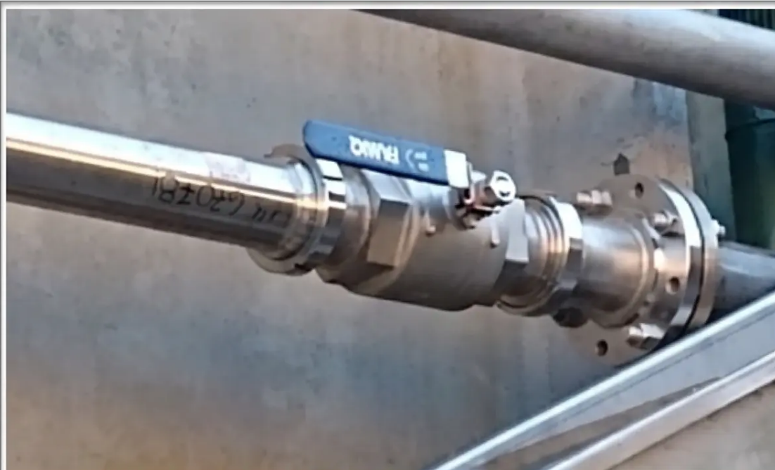
VÁLVULA Y CAÑERÍA 4"
