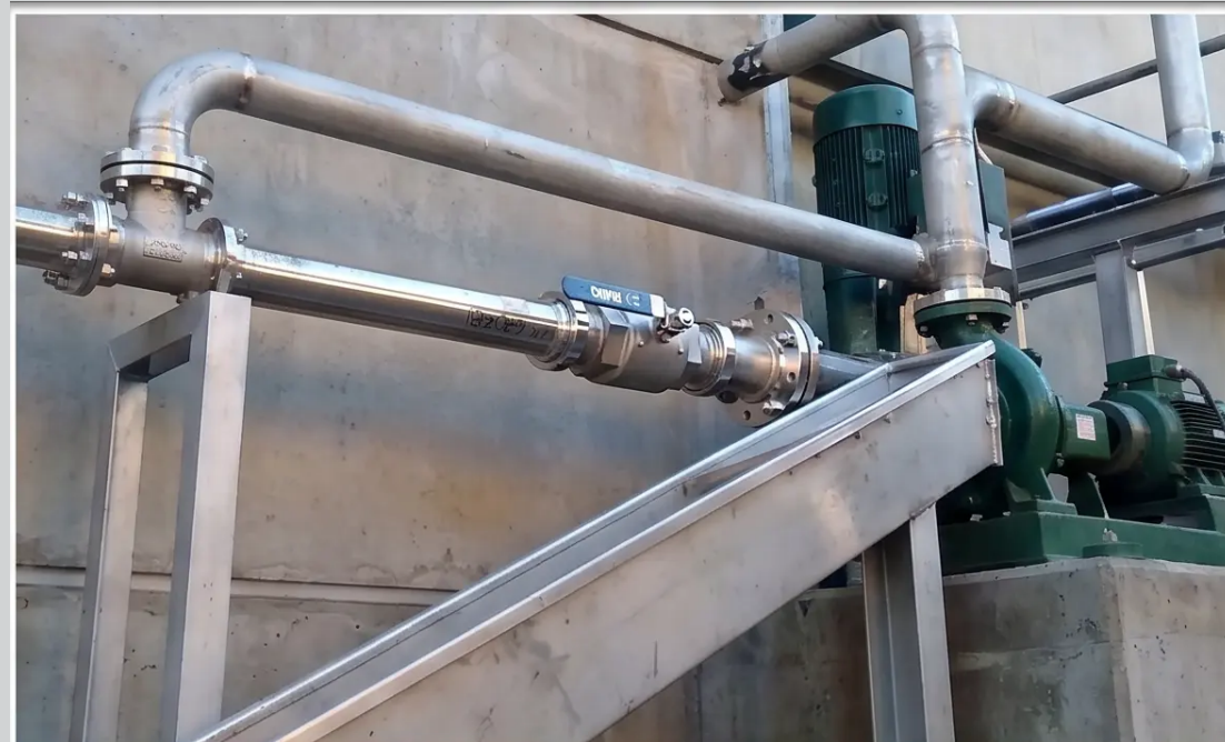
CAÑERÍA 4" Y BOMBAS
